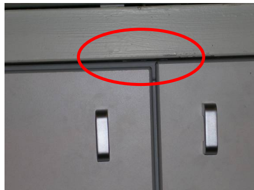
Defecto originado por mal posicionado de taladros.
